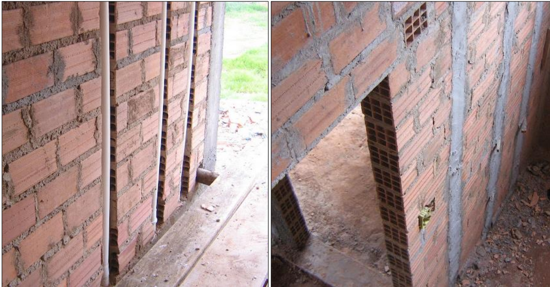
Figura 27: Condutores embutidos na parede:
