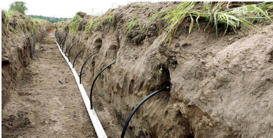
Figura 7 – Sistema de irrigação por gotejamento subsuperficial.
