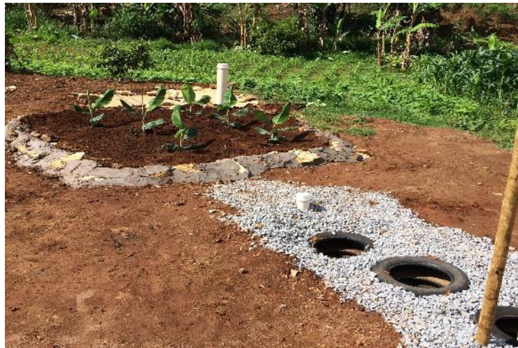
Figura 4.30. Visão geral do sistema de tratamento de efluentes. Fonte: Dados de pesquisa.
