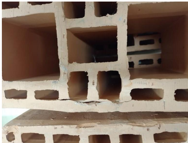
Figura 40: Bloco com trincas.
