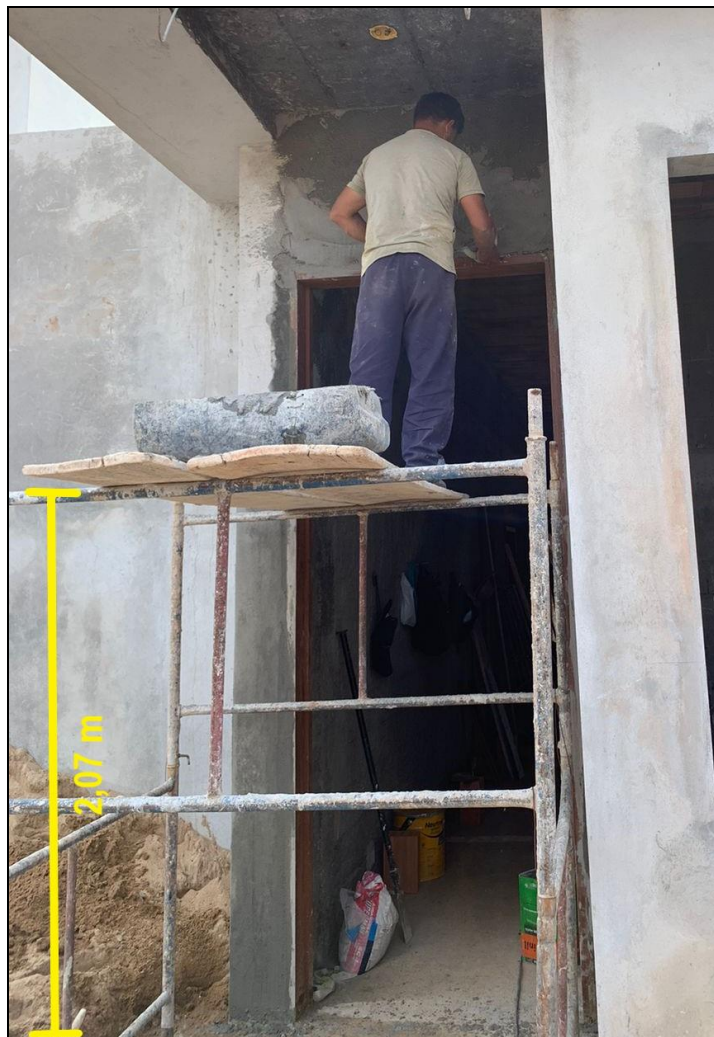
Figura 10 - Trabalhador executando trabalho em altura sem utilização de equipamentos de segurança
