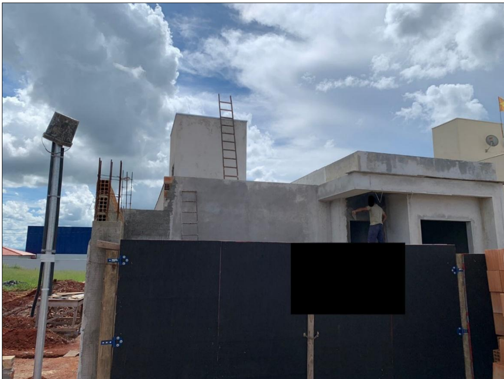
Figura 12 - Escadas que podem gerar risco de acidentes
