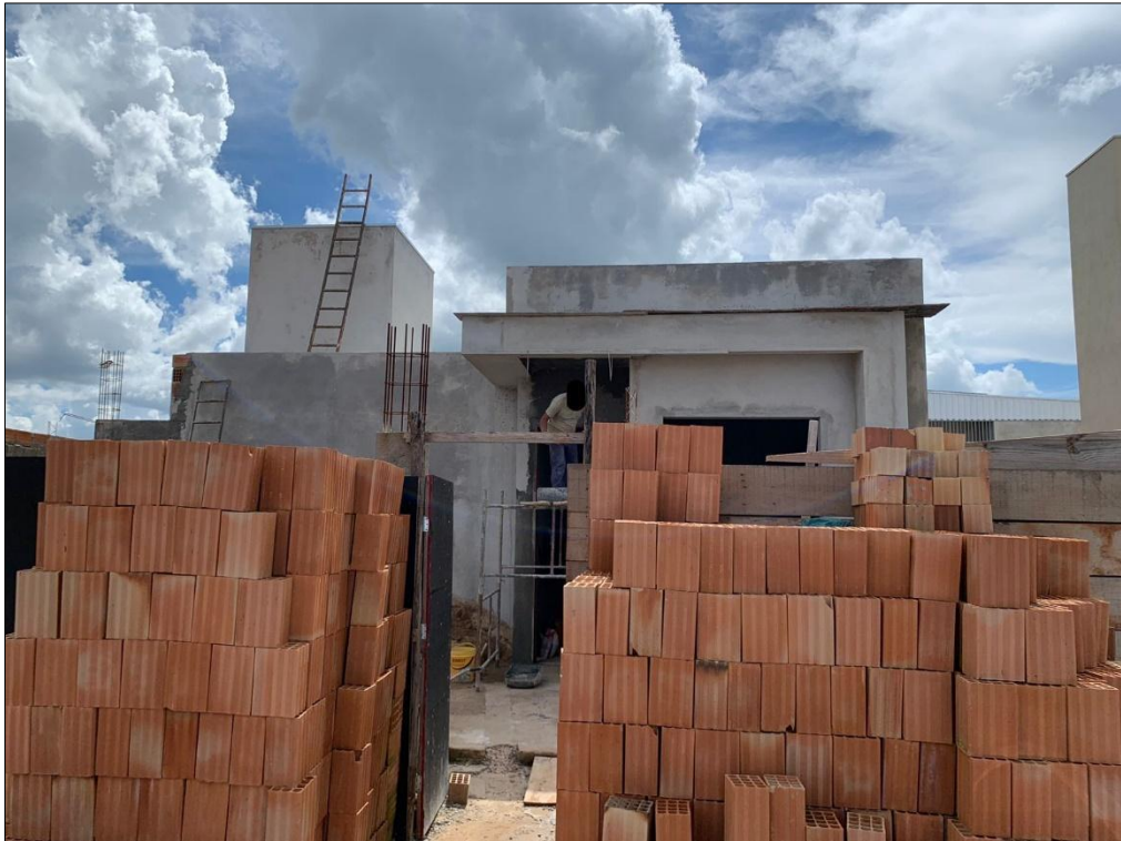
Figura 11 - Trabalhador executando serviços em altura sem EPI's e escadas que podem gerar risco de acidentes
