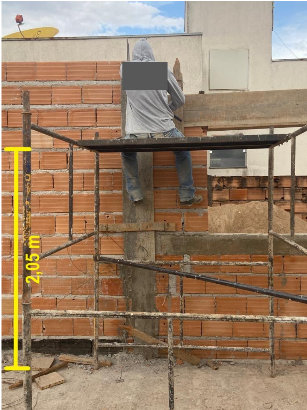
Figura 7 - Execução de trabalho em altura sem utilização de EPI's
