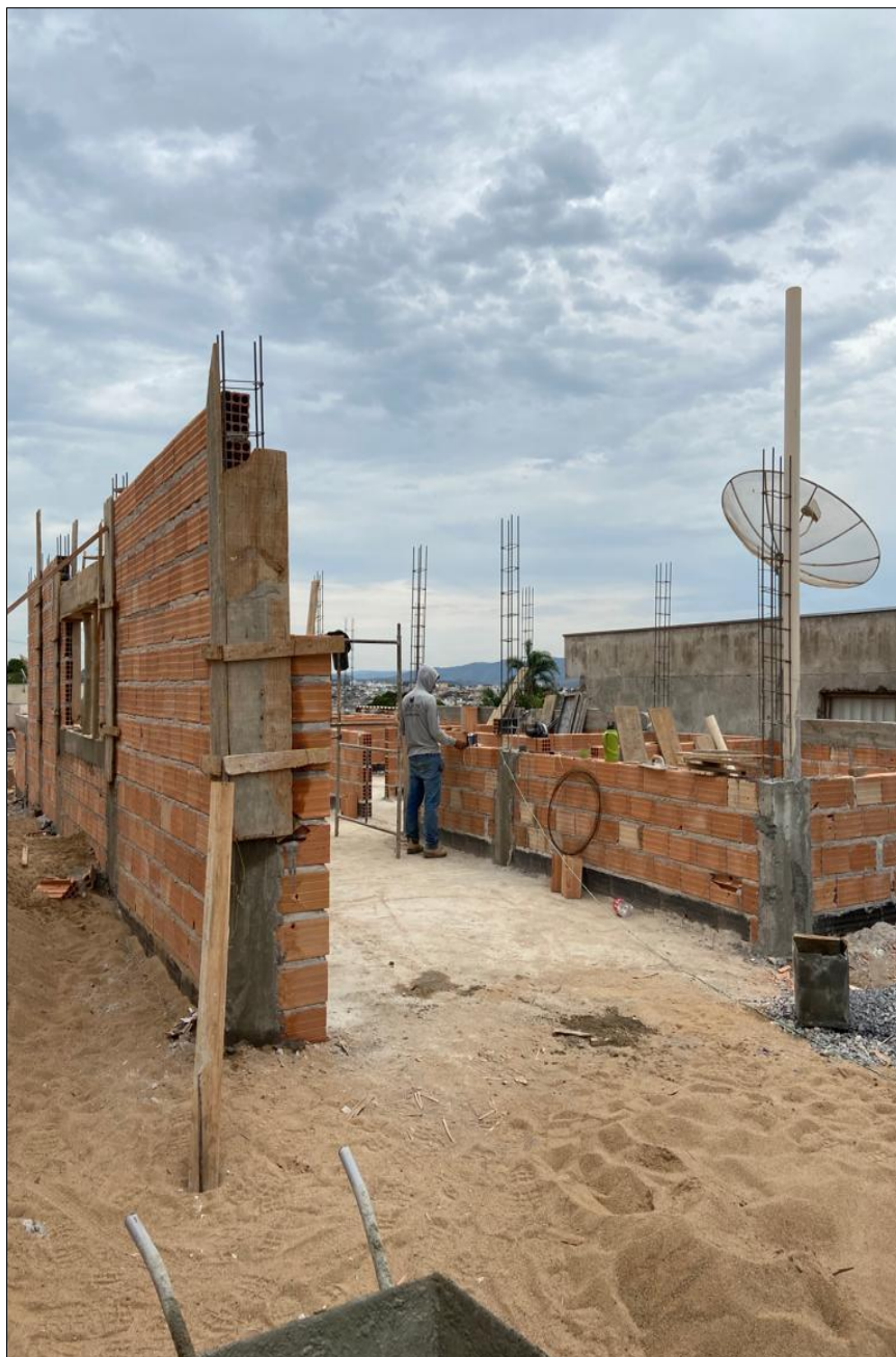
Figura 5 - Trabalhador sem EPI
