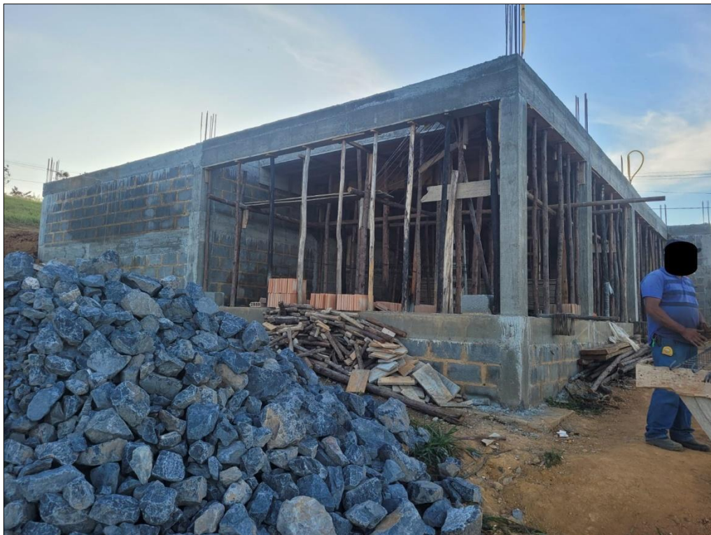
Figura 16 - Trabalhador não está utilizando todos os equipamentos de segurança necessários
