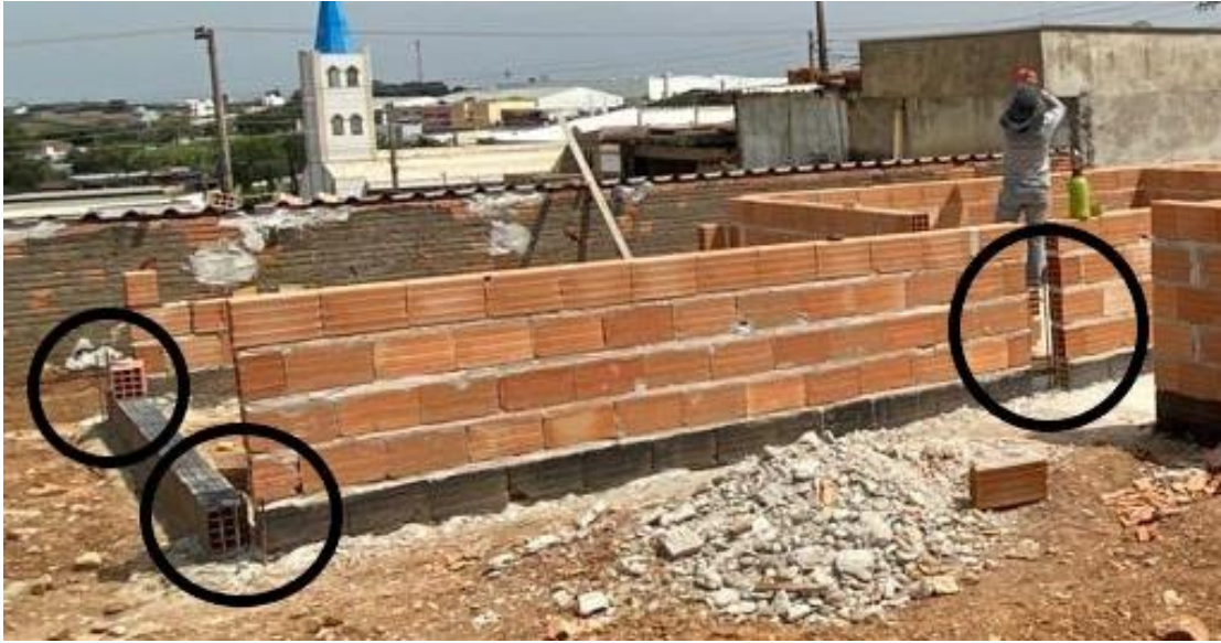
Figura 8 - Vergalhões sem protetores e trabalhador sem EPI's, gerando situações de risco.
