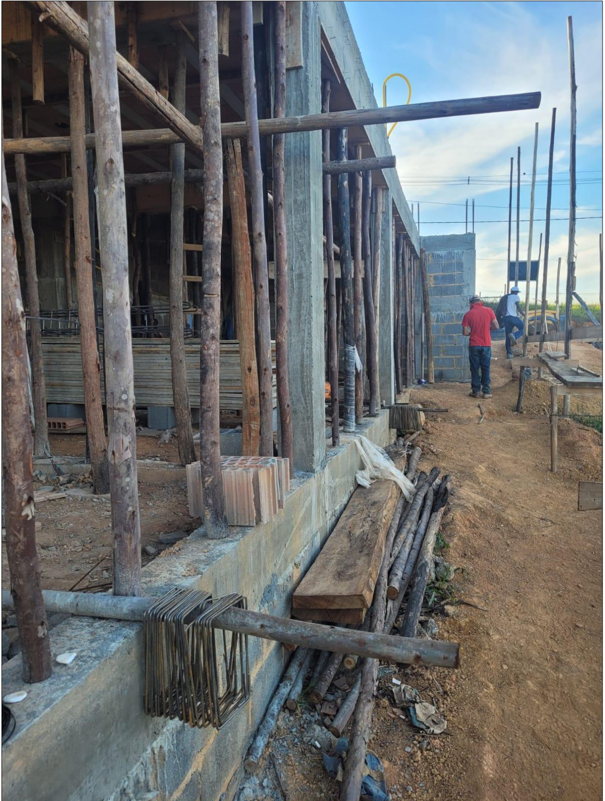
Figura 17 - Trabalhadores na obra sem utilizar EPI's
