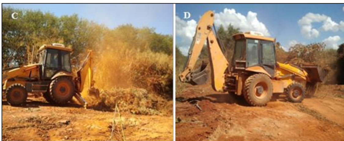
Figura 78 - Limpeza Mecânica do Terreno para construção do Posto de Recebimento em Bambuí – MG.
