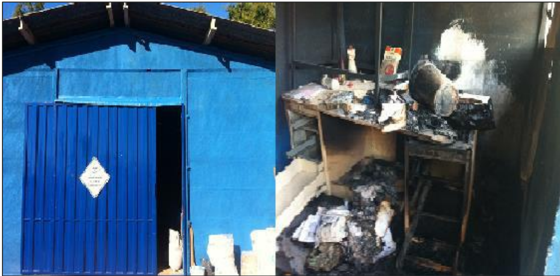
Figura 18 - Posto de Recebimento de Embalagens Vazias de Piumhi, antes e após o incêndio. Fonte: APASF (2015)
