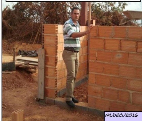
PAREDES DO BANHEIRO E ESCRITÓRIO
