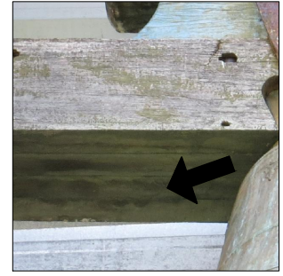
3 – Detalhe Mancha de umidade Foto: Marília Sinimbú, 2023.
