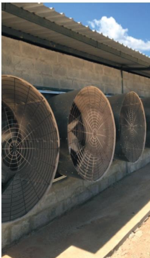
Figura 5 – Exaustores com cone
