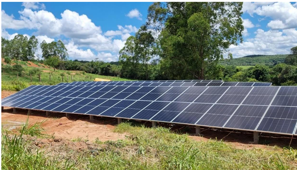
Figura 1 - Módulos de geração de energia fotovoltaicos da microusinha já instalados
