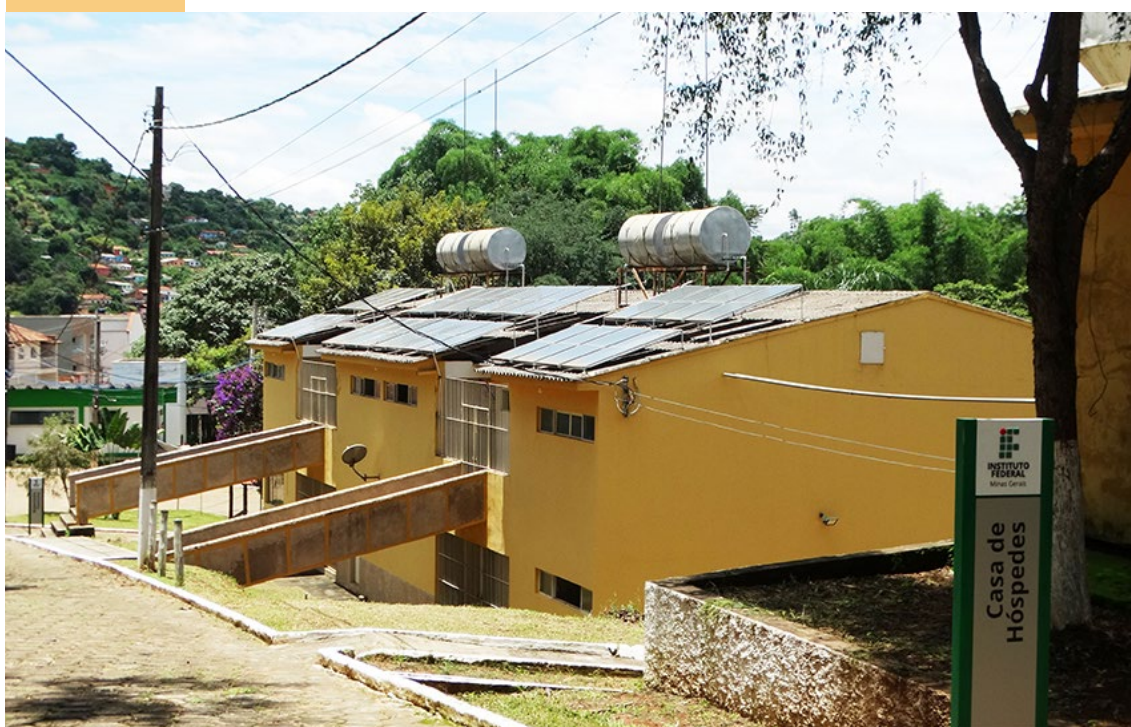
Figura 49 . Placas de captação de energia solar.
