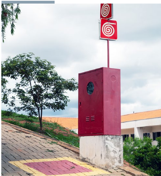
Figura 61 . Equipamento de combate a incêndio.
