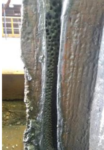
Figura 7 - Bloco de aço com presença de bolhas de hidrogênio
