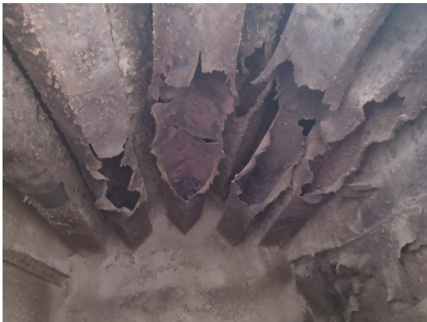
Figura 5.2 – Aquecedor a lenha com os tubos trocadores de calor danificados
