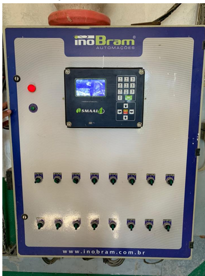
Figura 4.5 – Central de controle
