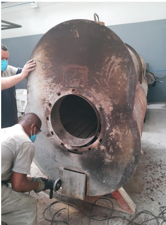
Figura 5.4 – Aquecedor a lenha em processo de manutenção com pintura deteriorada
