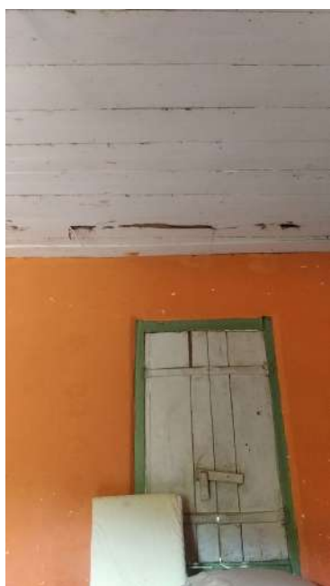
Figura 58- Forro atacado por xilófago.
