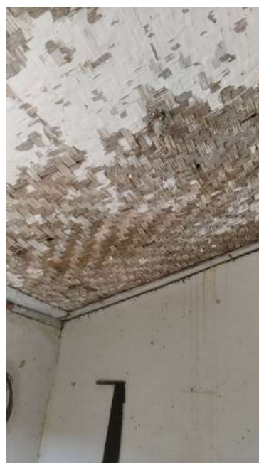
Figura 59- Forro de taquara com perda da camada pictórica.
