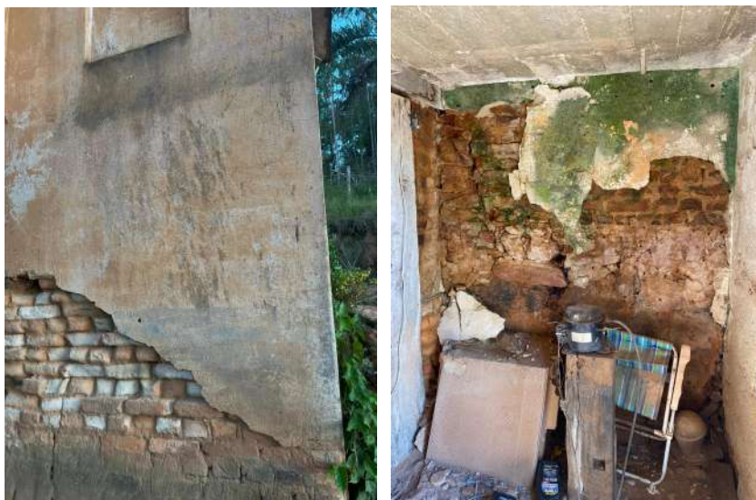
Figura 55- Perda da camada de reboco.
