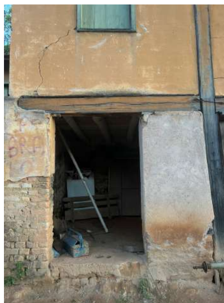
Figura 54- Ressecamento das madeiras aparentes, além de trincas e sujidade presente.
