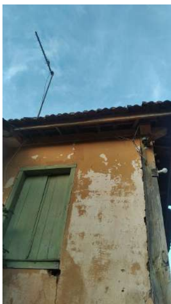
Figura 53- Perda de material e perda da camada pictórica.
