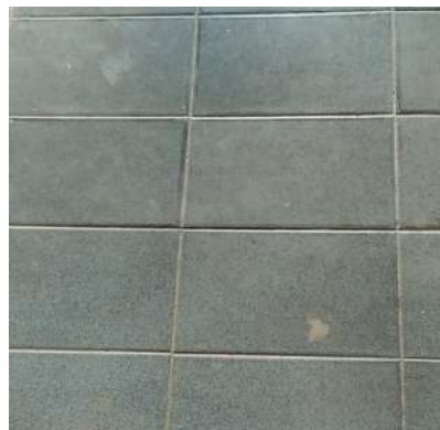
Figura 40- Piso de cerâmica. Fonte: Mikhaely Souza, 2023.
