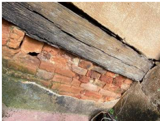
Figura 57- Ressecamento da madeira, perda de reboco, biofilme.
