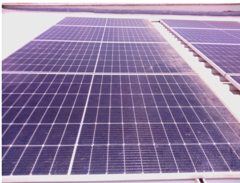
Figura 21 – Usina Telhado - Empoeirada.
