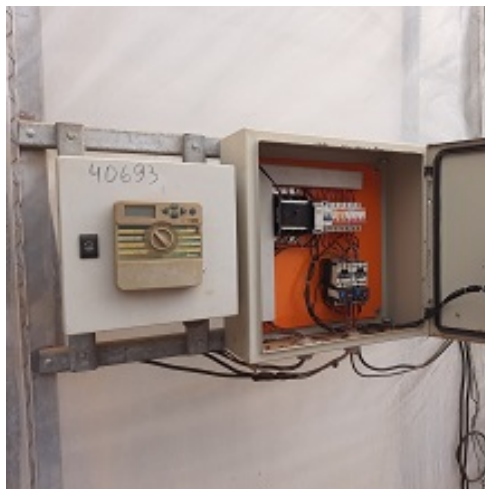
(a) – Painéis elétricos.
