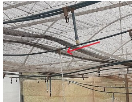
(b) Aspersores quebrados.
