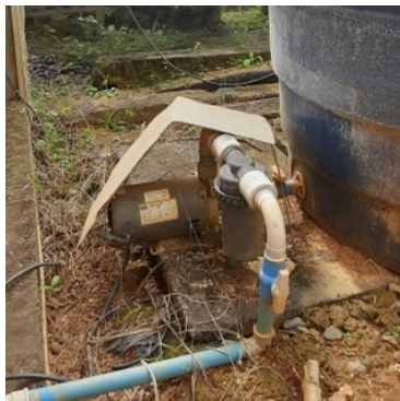
(a) Bomba d'água conectada à caixa d'água.
