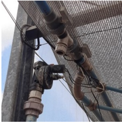
(a) Válvula danificada.
