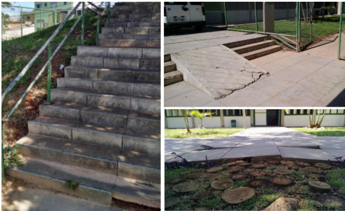
Figura 19 - Espaços sem acessibilidade
