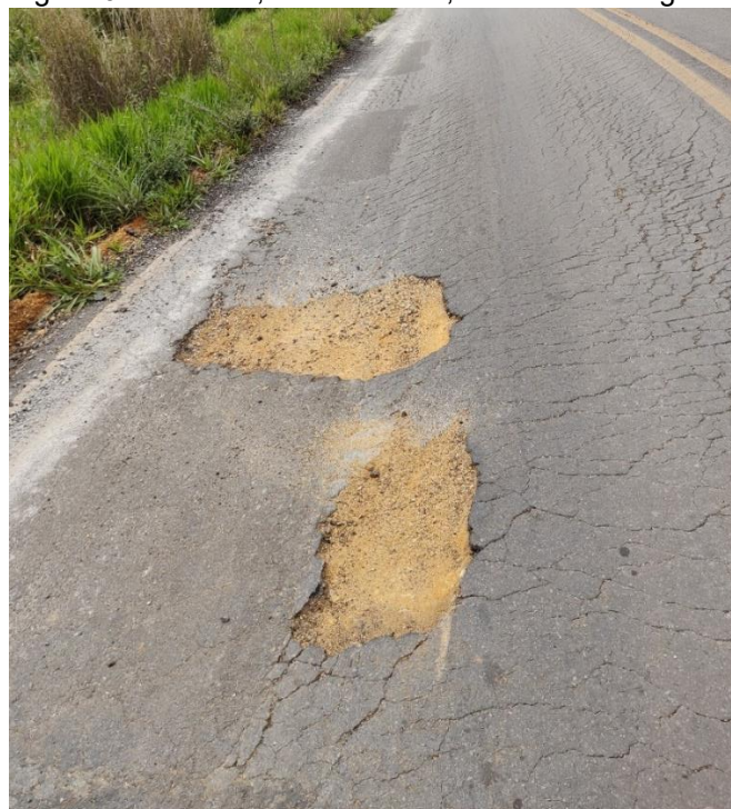
Figura 67 - Trincas, afundamento, remendo e desgaste.
