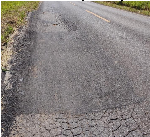
Figura 61 - Remendo, afundamento, escorregamento, desgaste, exsudação e trincas.
