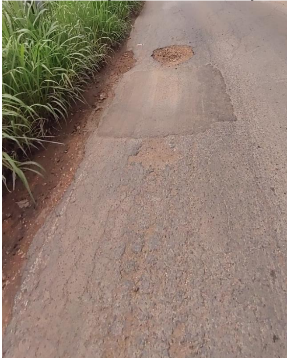
Figura 52 - Trincas, desgaste, remendo, ondulação e panela.
