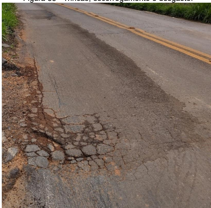
Figura 55 - Trincas, escorregamento e desgaste.
