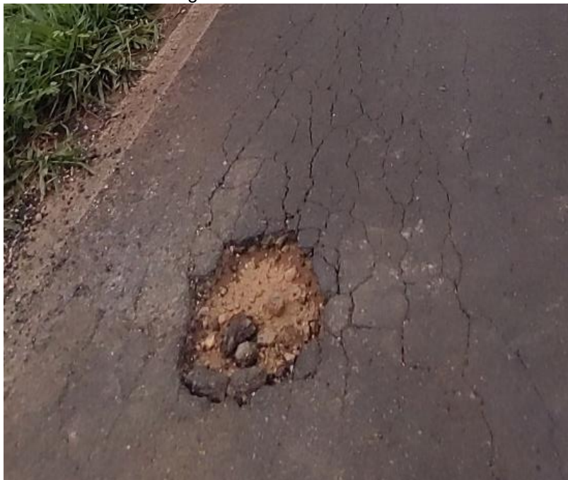
Figura 45 - Panela e trincas.
