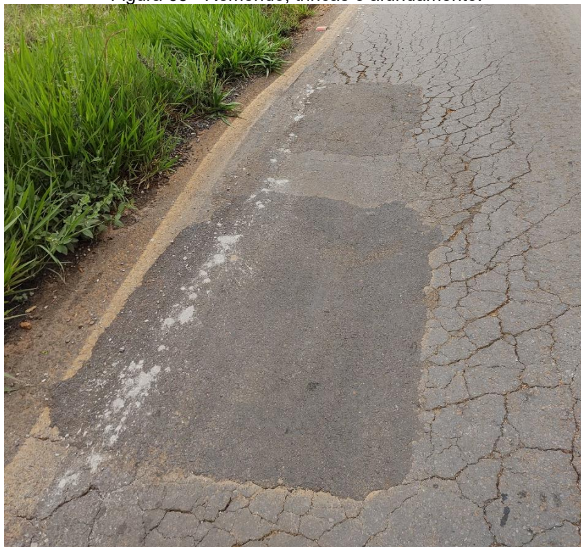
Figura 65 - Remendo, trincas e afundamento.
