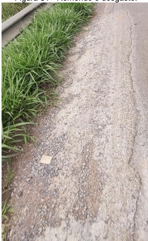
Figura 51 - Remendo e desgaste.
