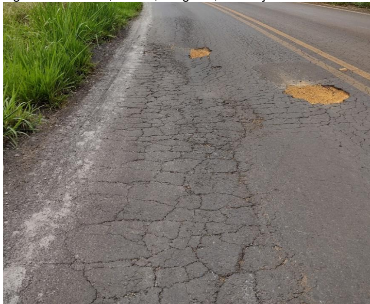
Figura 66 - Panela, trincas, desgaste, ondulação e afundamento.
