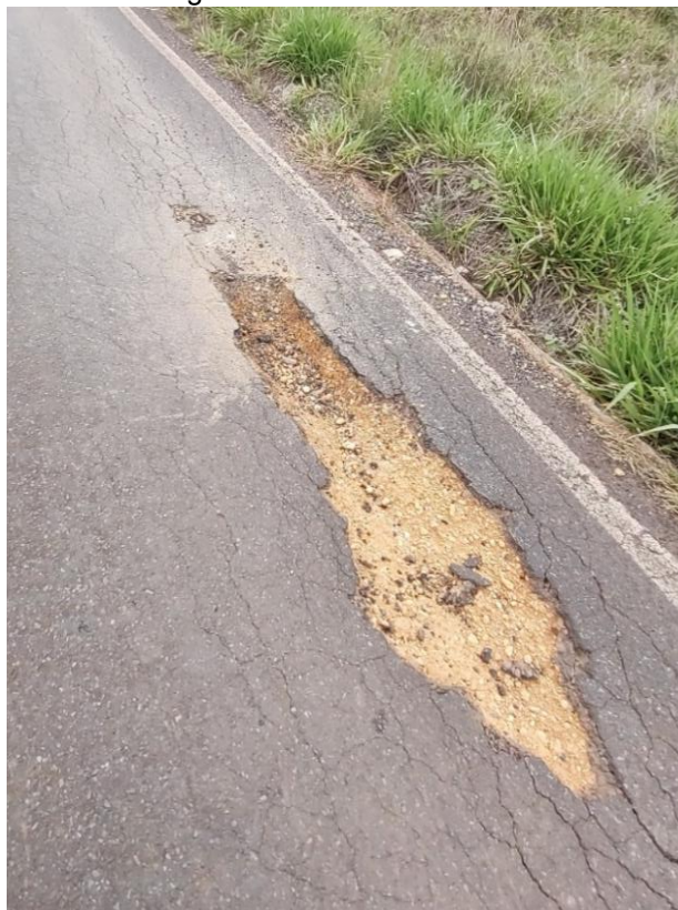
Figura 47 - Panela e trincas.
