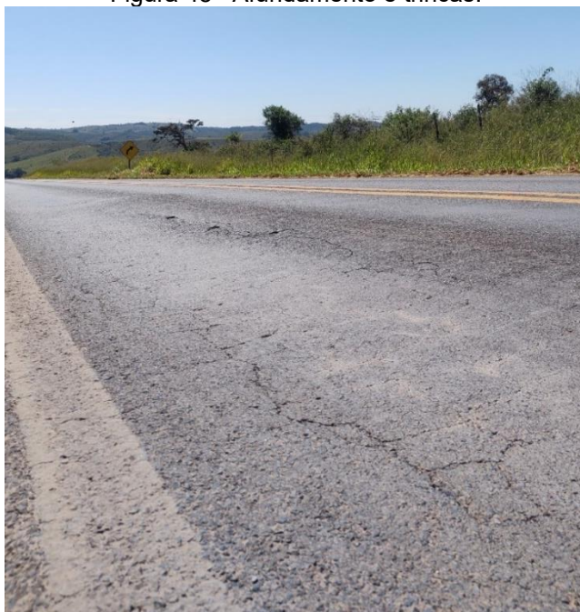
Figura 48 - Afundamento e trincas.
