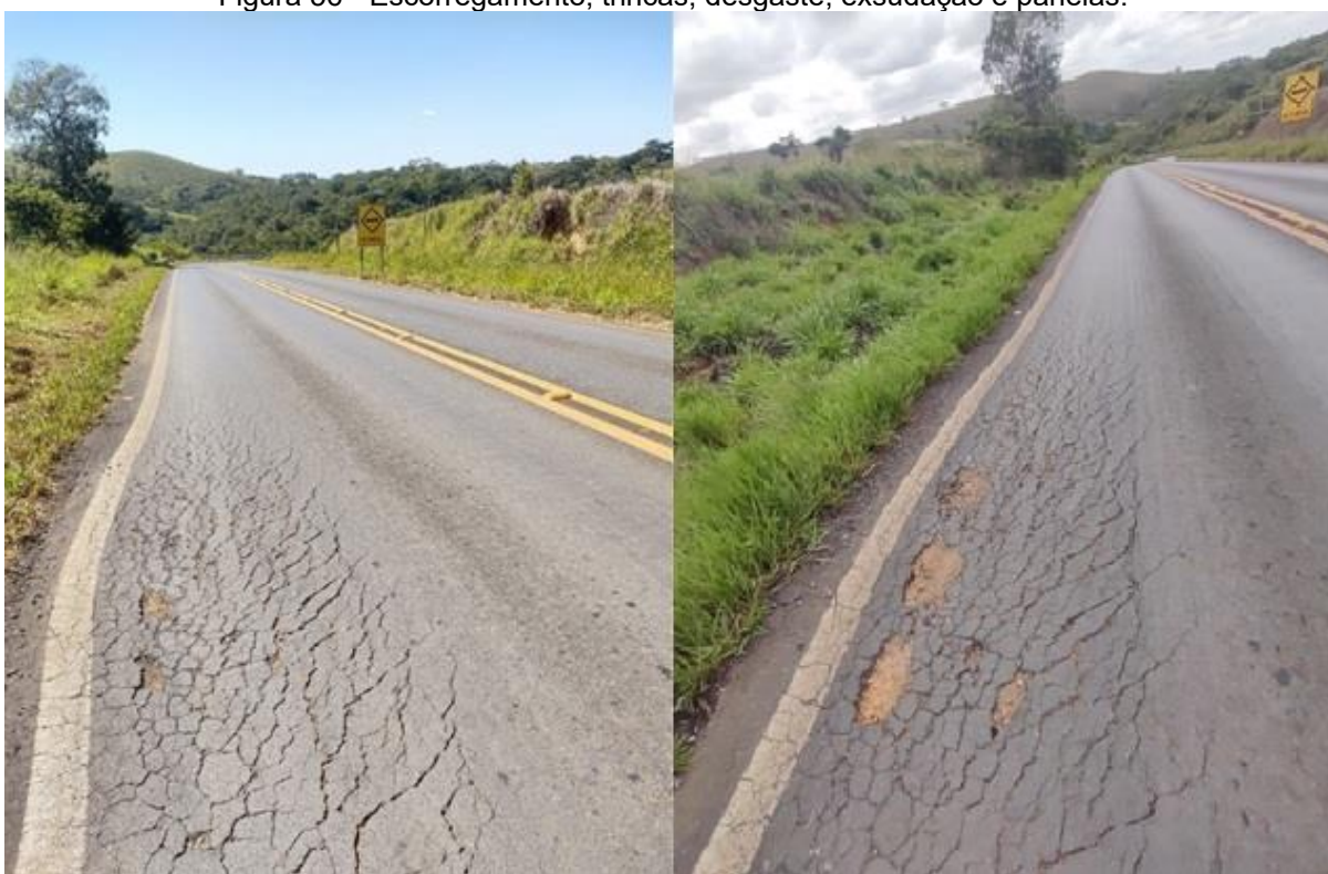
Figura 56 - Escorregamento, trincas, desgaste, exsudação e panelas.
