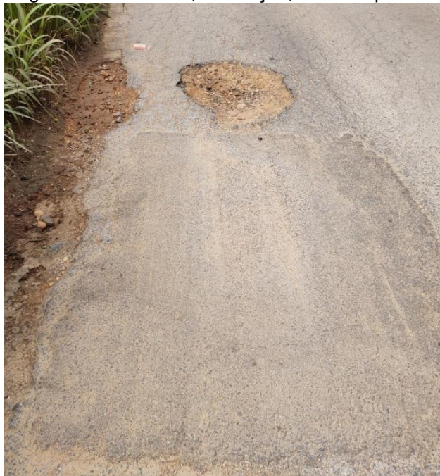
Figura 54 - Remendo, ondulação, trincas e panela.
