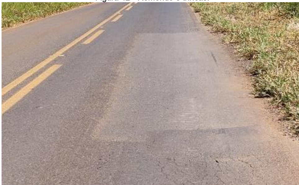
Figura 42 - Remendo e trincas.
