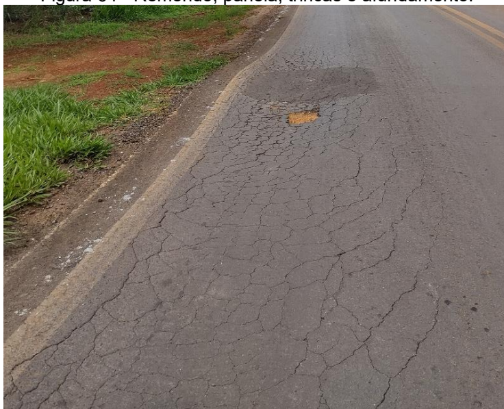
Figura 64 - Remendo, panela, trincas e afundamento.
