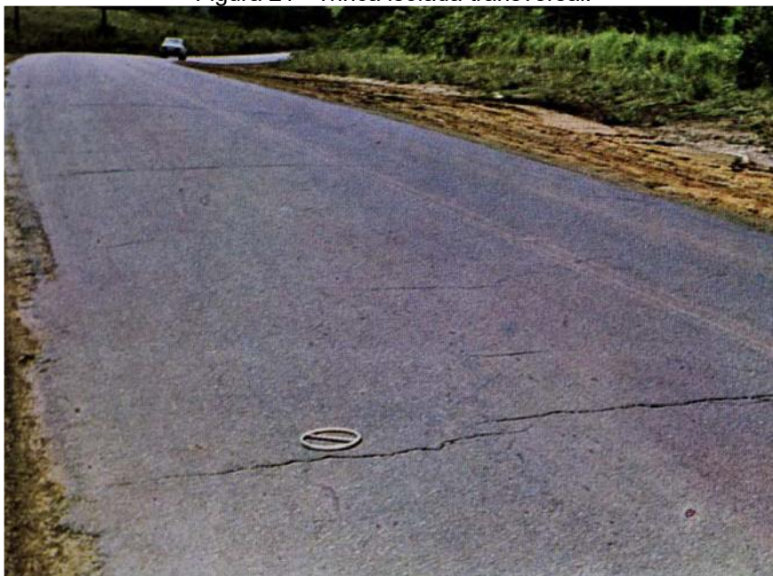
Figura 21 - Trinca isolada transversal.
