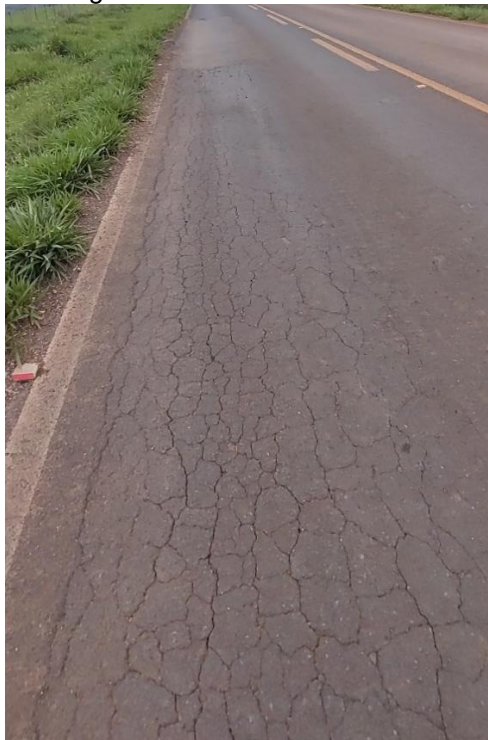
Figura 43 - Remendo e trincas.
