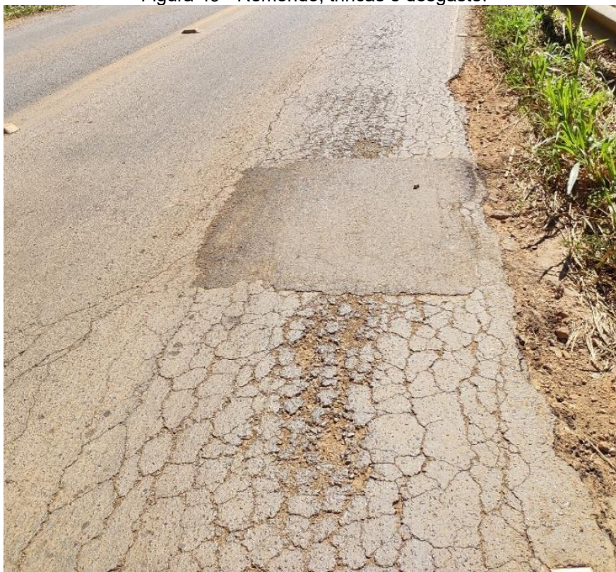
Figura 49 - Remendo, trincas e desgaste.
