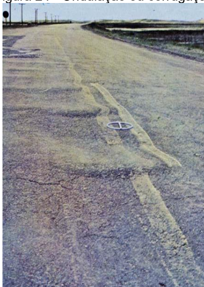
Figura 24 - Ondulação ou corrugação.
