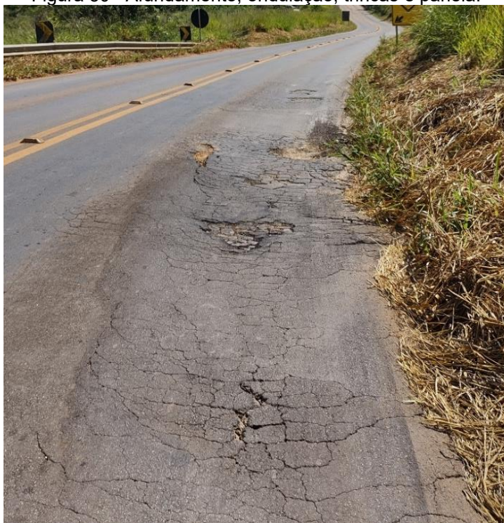
Figura 50 - Afundamento, ondulação, trincas e panela.
