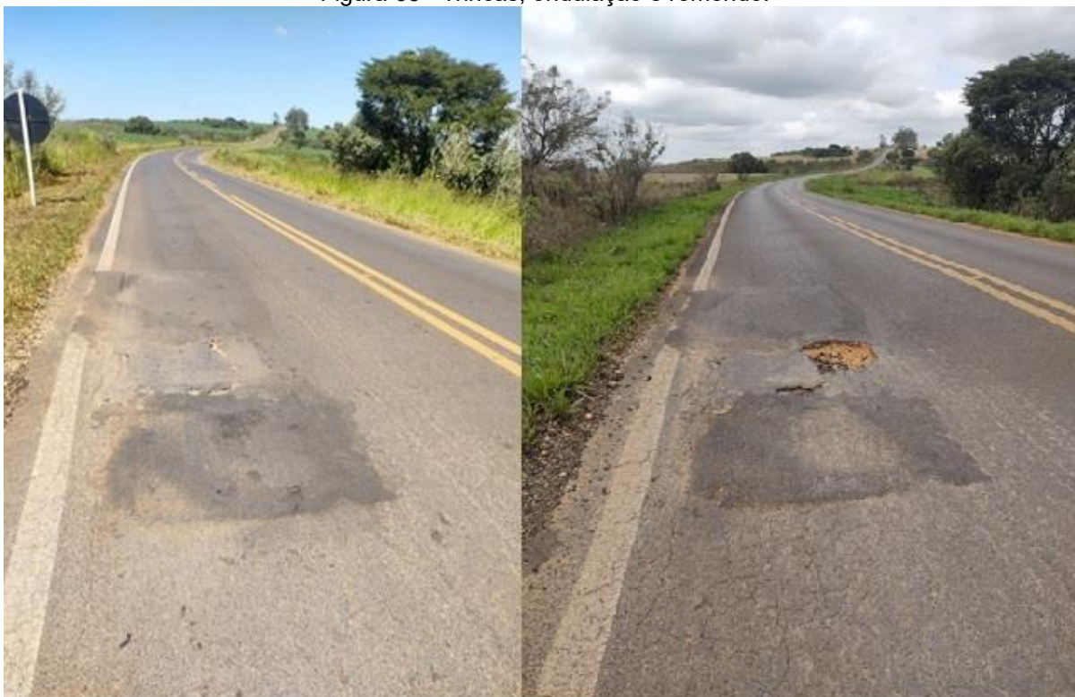
Figura 63 - Trincas, ondulação e remendo.
