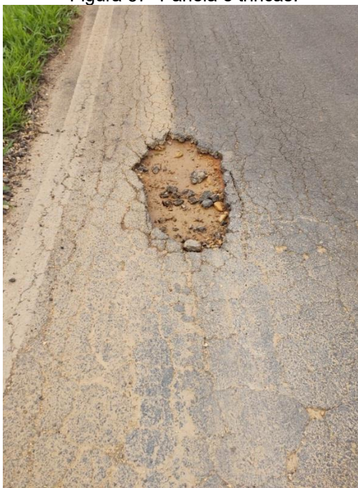
Figura 57 -Panela e trincas.
