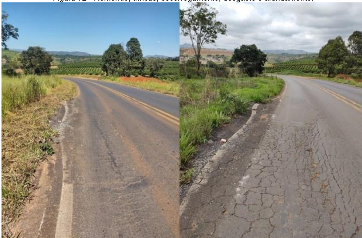
Figura 72 - Remendo, trincas, escorregamento, desgaste e afundamento.
