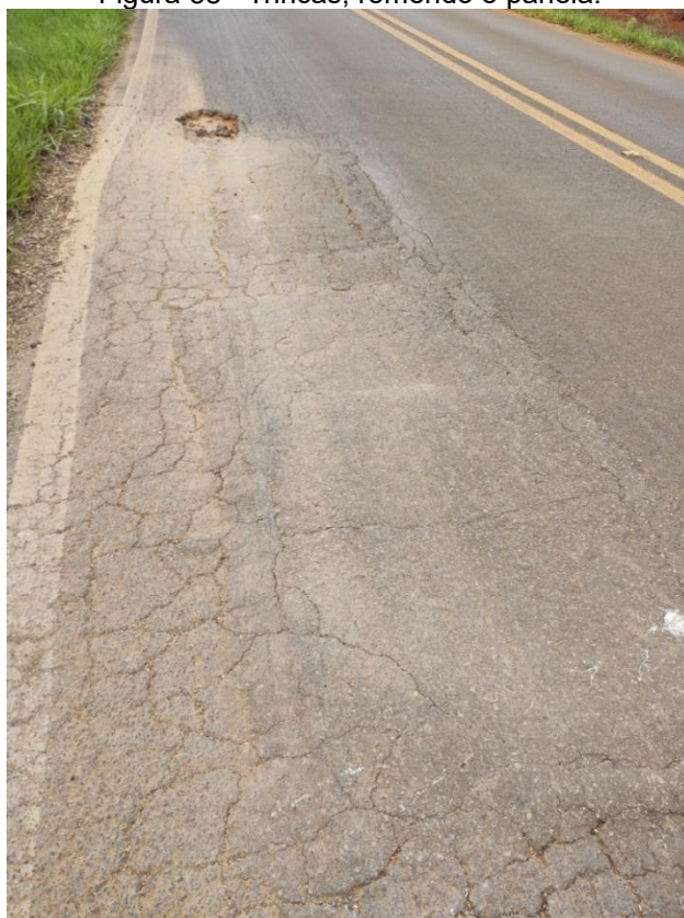
Figura 58 - Trincas, remendo e panela.
