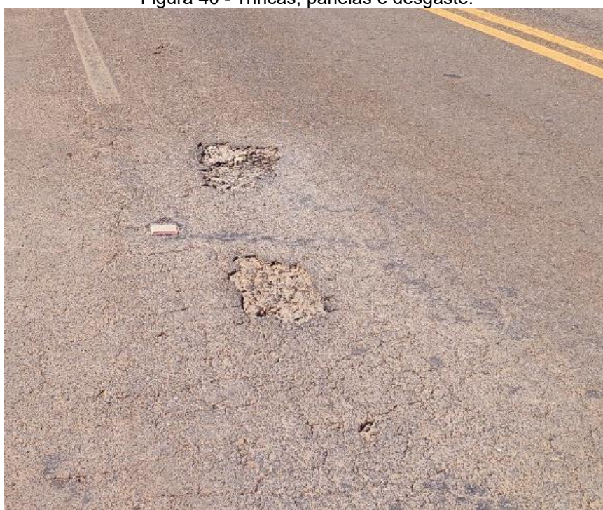
Figura 40 - Trincas, panelas e desgaste.
