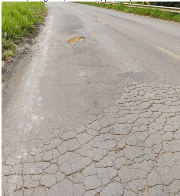
Figura 68 - Escorregamento, desgaste, remendo, panela, afundamento, trincas e ondulação.
