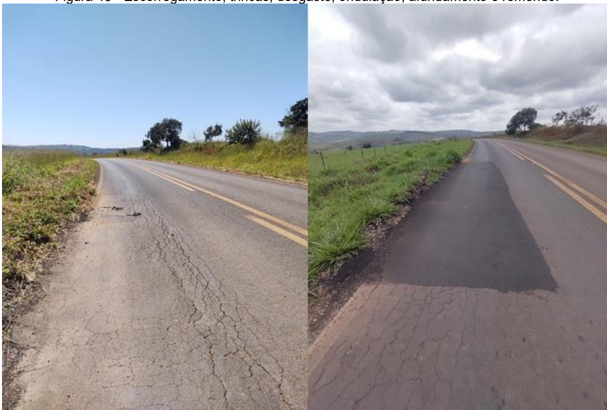
Figura 46 - Escorregamento, trincas, desgaste, ondulação, afundamento e remendo.
