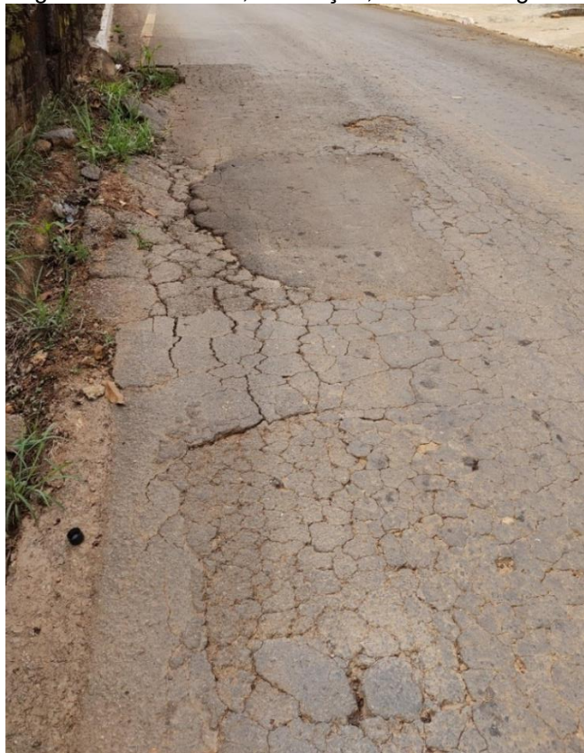
Figura 70 - Remendo, ondulação, trincas e desgaste.
