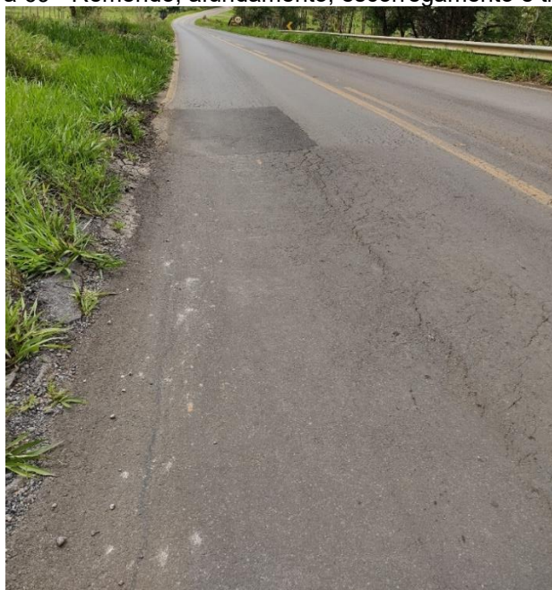
Figura 69 - Remendo, afundamento, escorregamento e trincas.
