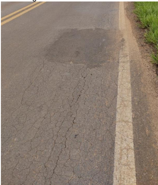
Figura 59 - Remendo e trincas.
