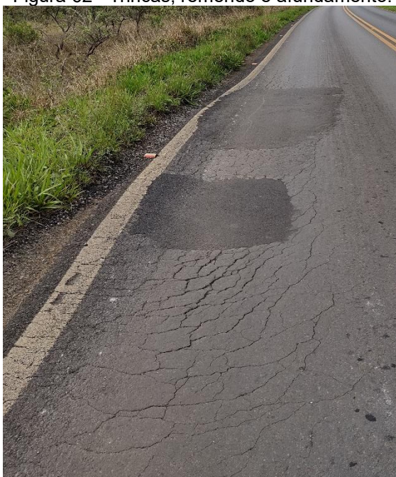
Figura 62 - Trincas, remendo e afundamento.
