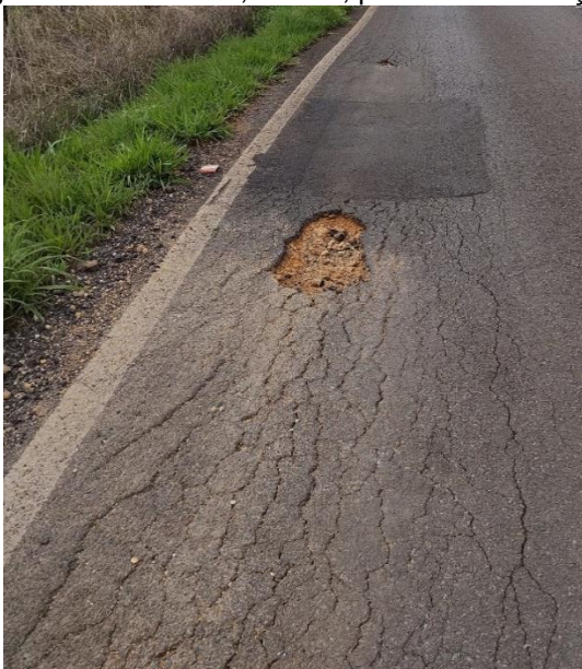
Figura 60 - Remendo, trincas, panela e exsudação.
