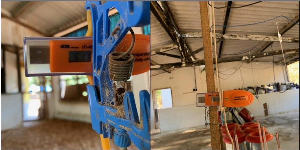
Figura 4 - Instrumento de medição instalado no interior dos aviários
