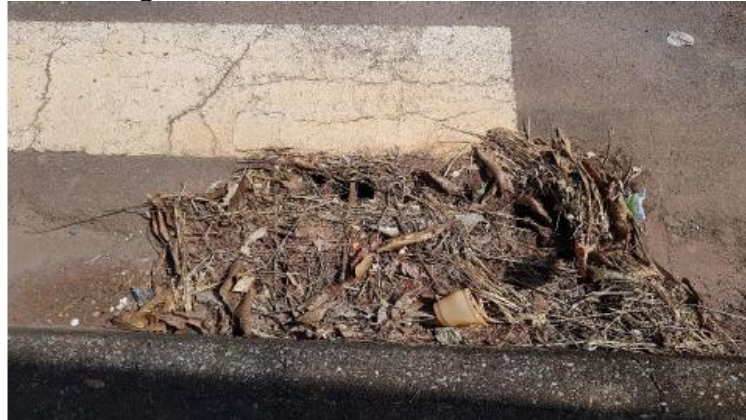
Figura 3 – Boca de lobo em Piumhi - MG
