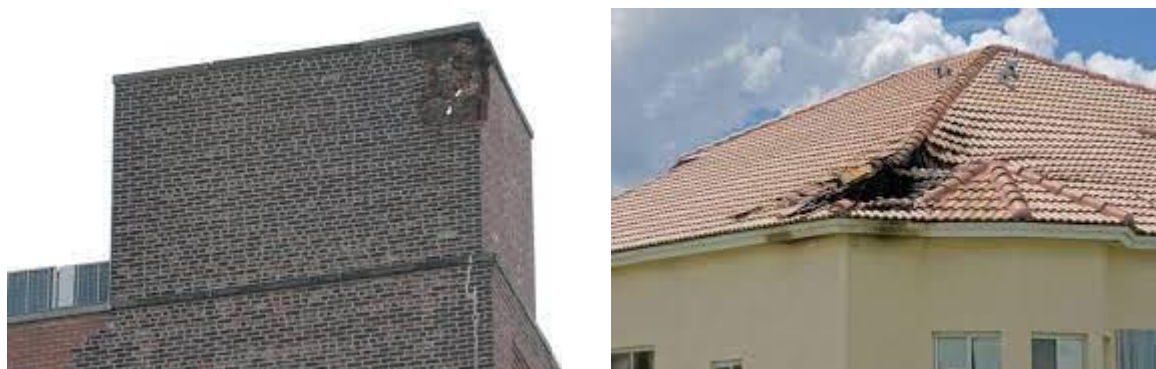
Figura 2 - Danos causados por descargas atmosféricas
