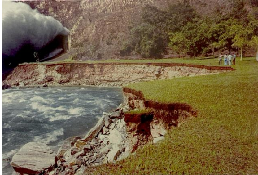
Figura 10 - Erosão na margem esquerda da UHE Estreito.
