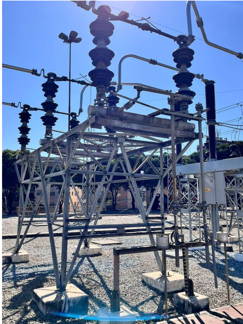
Figura 21 – Seccionadora com lâmina de terra.
