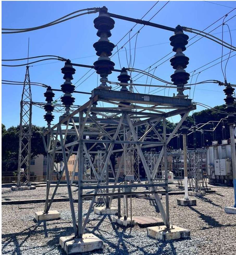
Figura 22 – Seccionadora sem lâmina de terra.
