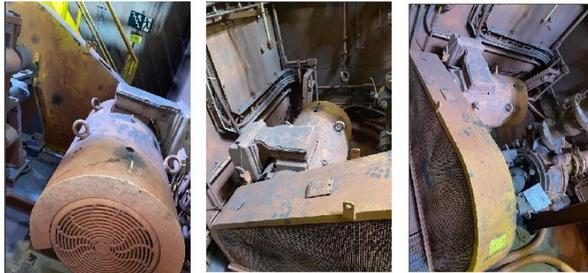
Figura 20 – Motor de indução trifásico selecionado para análise, incluindo sua localização na área industrial, os componentes periféricos.
