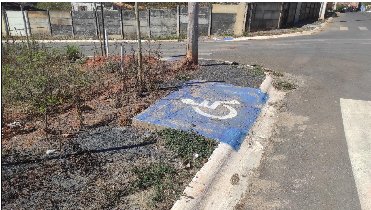
Figura 42: Rebaixamento da calçada na Avenida Primeiro de Janeiro em local sem calçamento.
