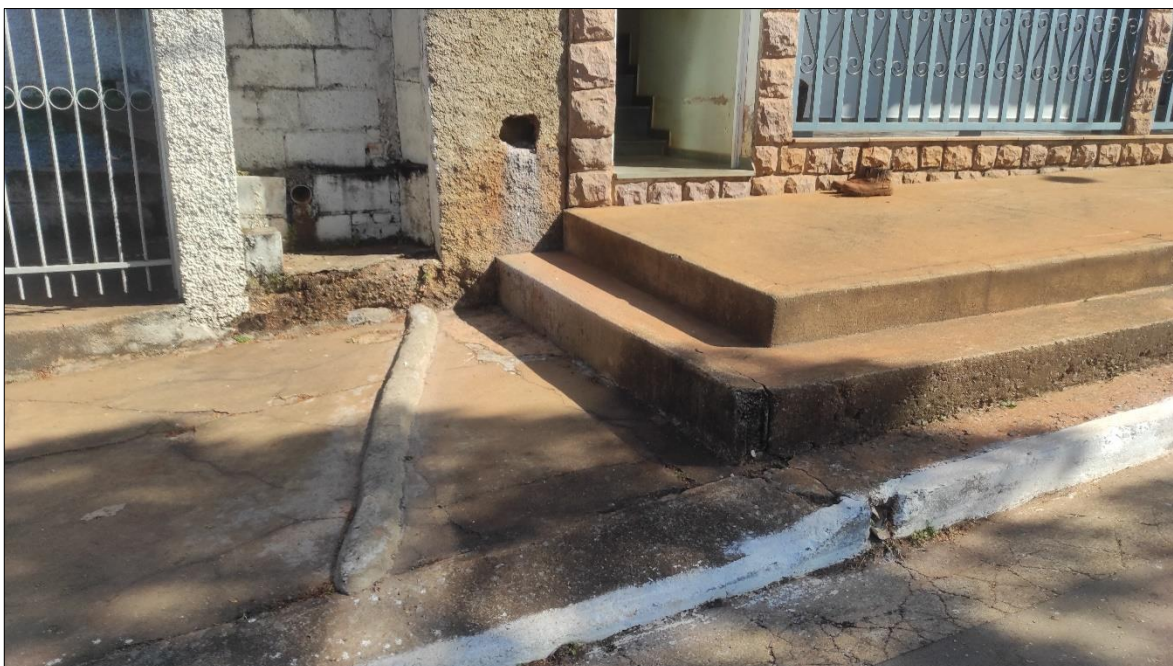
Figura 38: Descontinuidade na Avenida Primeiro de Janeiro.
