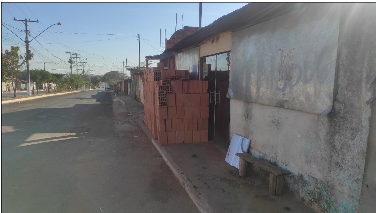
Figura 61: Materiais armazenados na calçada da Avenida Aristides Garcia Leão.
