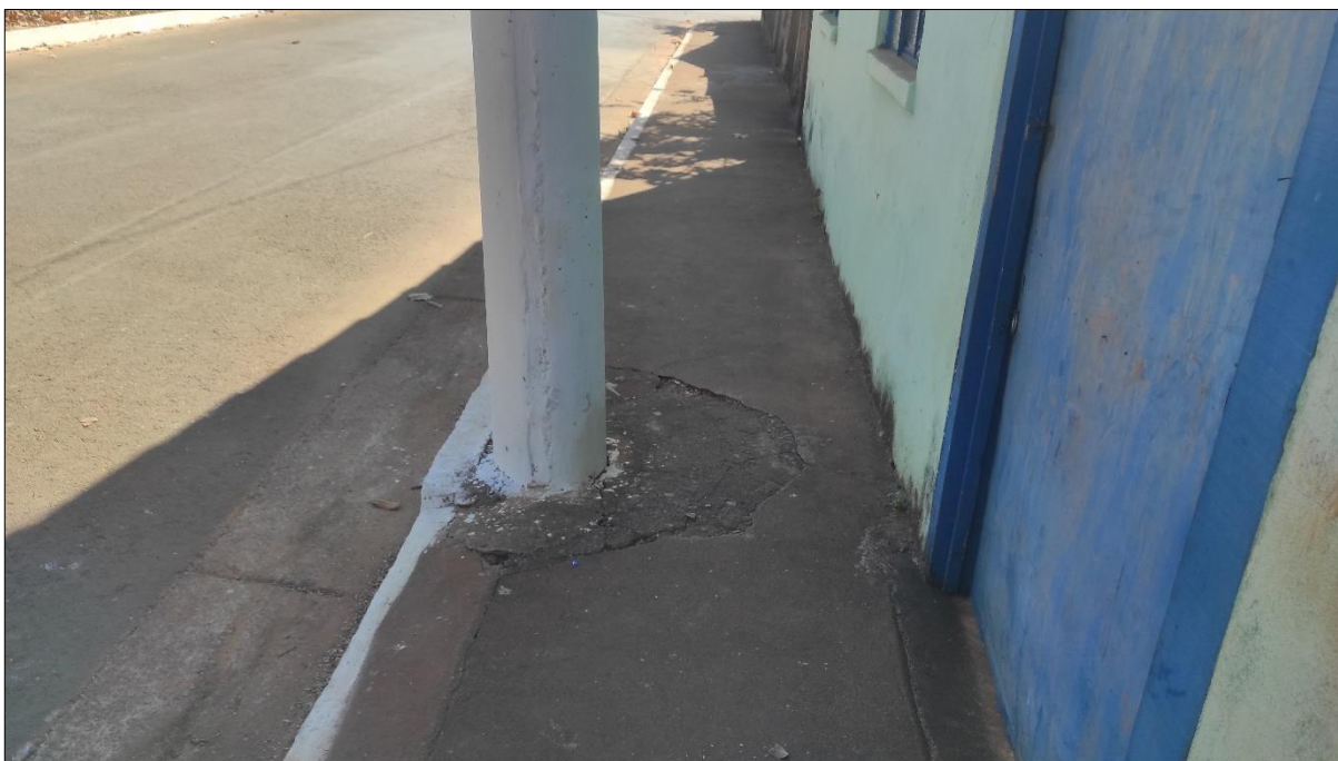
Figura 45: Presença de postes na calçada da Avenida Primeiro de Janeiro.
