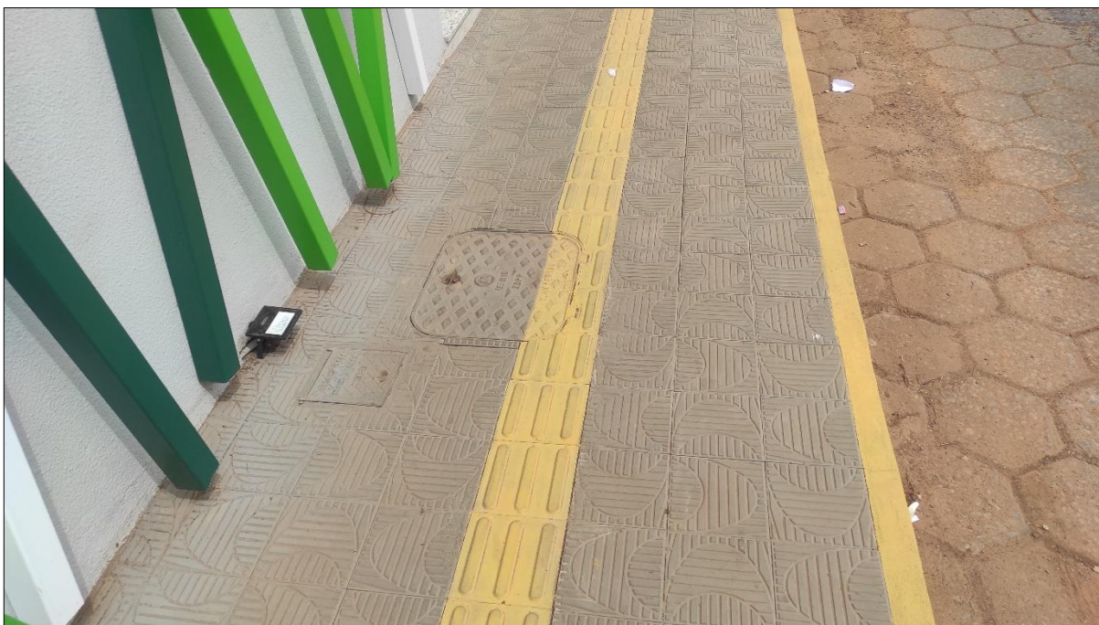
Figura 65: Irregularidade na calçada da Rua Olinto Fonseca.
