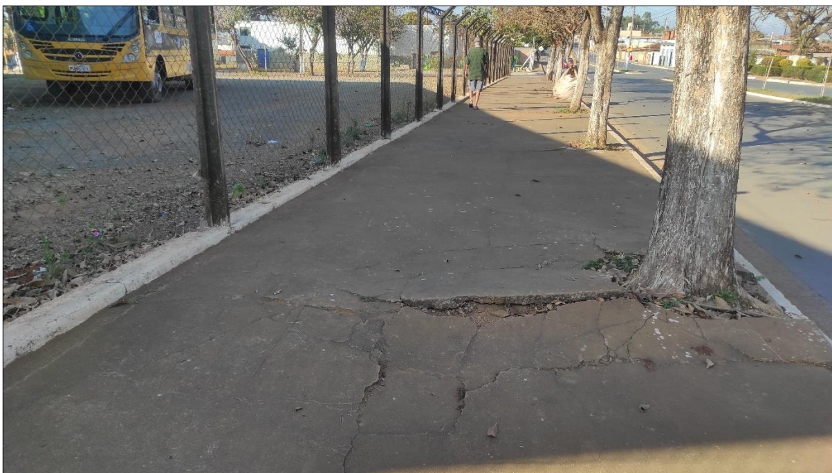
Figura 54: Trincas na calçada da Avenida Aristides Garcia Leão.
