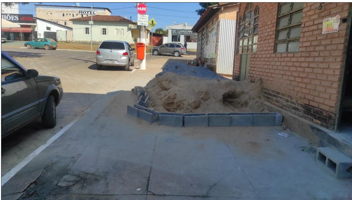
Figura 60: Materiais armazenados na calçada da Avenida Juscelino Kubitscheck.
