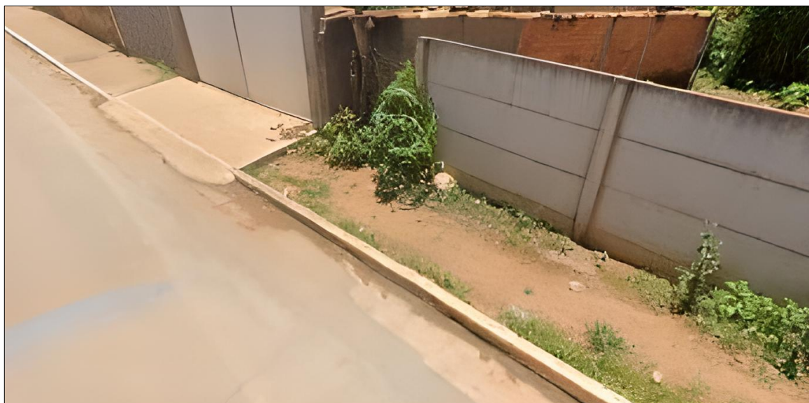
Figura 1: Descontinuidade de uma calçada de Pimenta-MG
