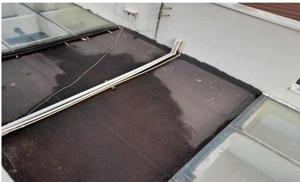
Figura 35 - Manta asfáltica com água empoçada.
