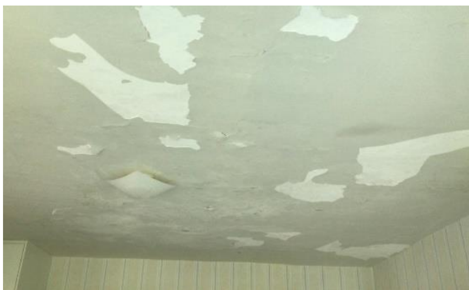
Figura 34 - Infiltração no forro.
