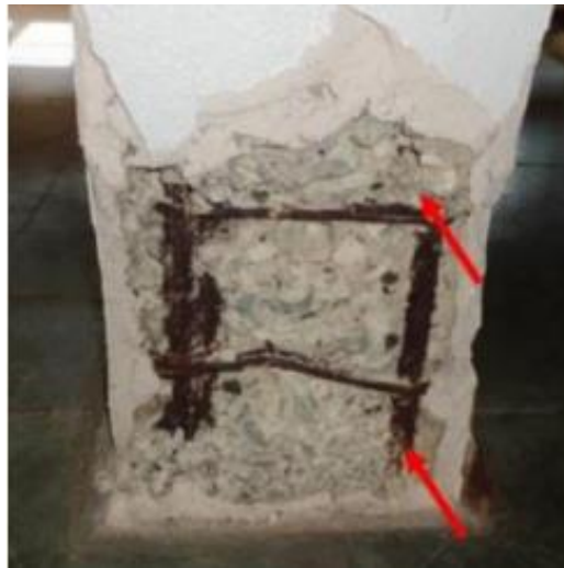
Figura 4 - Corrosão da armadura em pilar.
