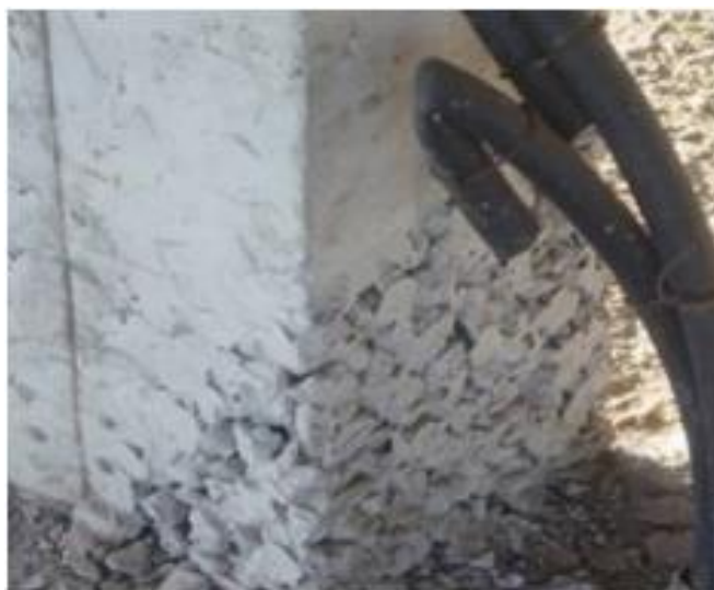
Figura 16 - Ninhos no concreto.
