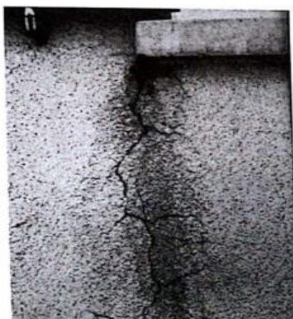
Figura 5 - Exemplo de fissuras em alvenaria com maior contato com a água.
