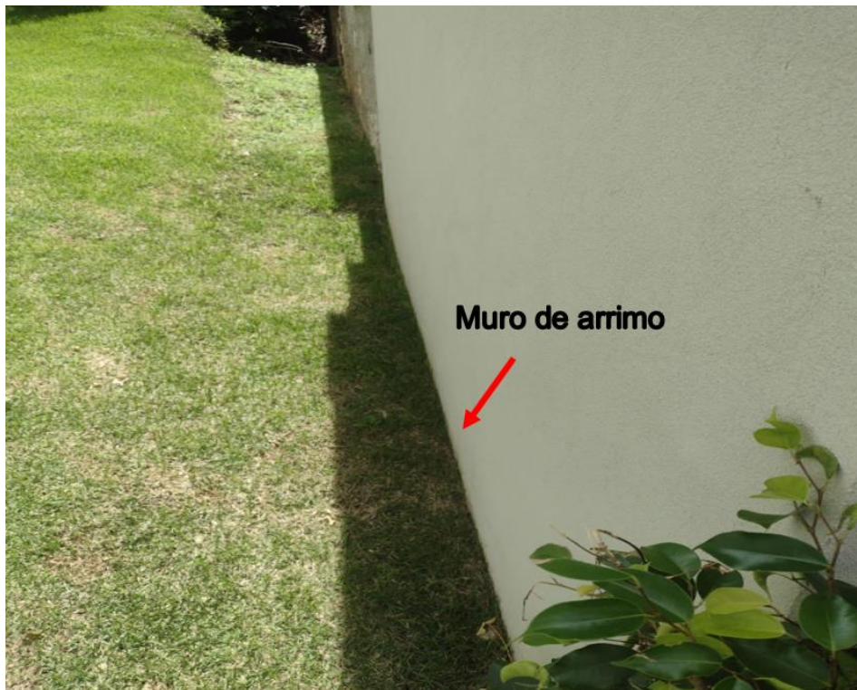
Figura 37 - Infiltração em parede de muro de arrimo.
