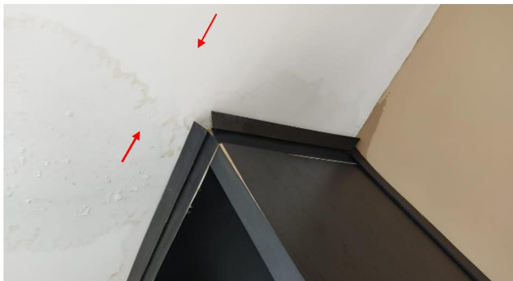
Figura 33 - Infiltração no forro de gesso.
