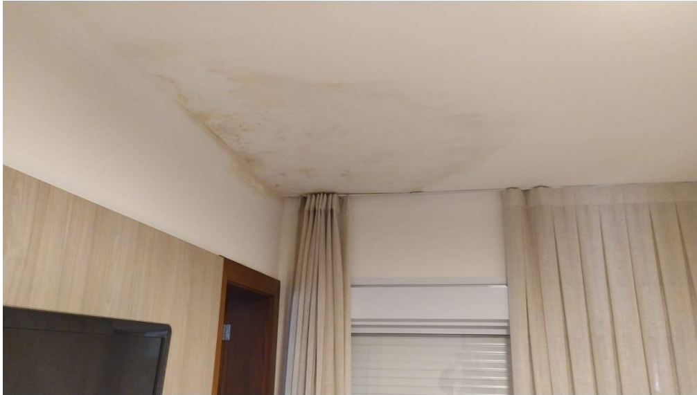
Figura 31 - Infiltração em laje.
