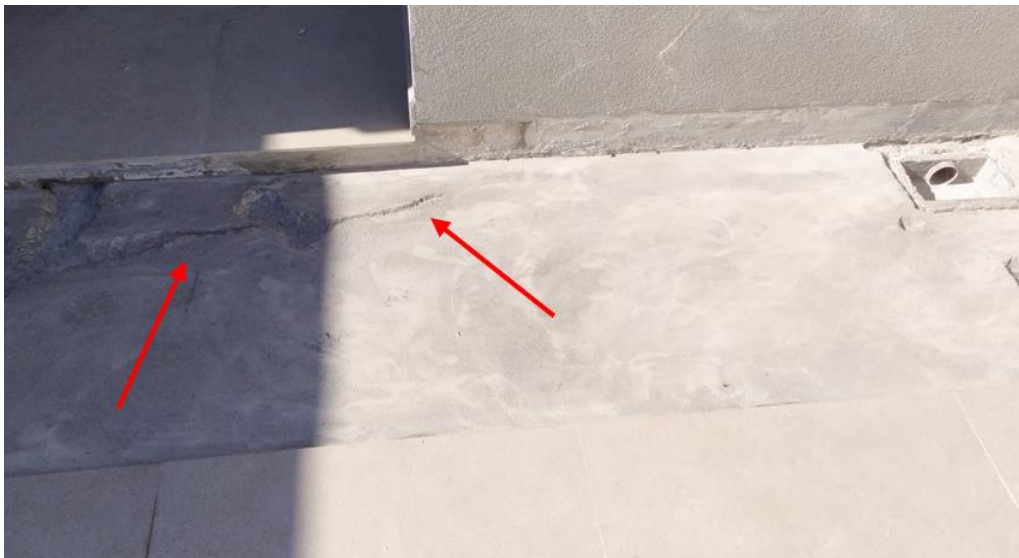
Figura 32 - Trinca aberta, após remoção da cerâmica.
