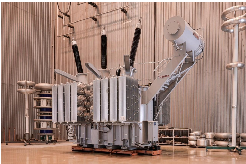
Figura 1 – Transformador de grande porte.
