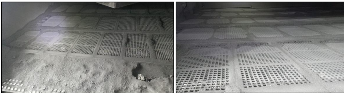
Figura 26 – Finos aderidos na superfície de peneiramento do segundo deck
