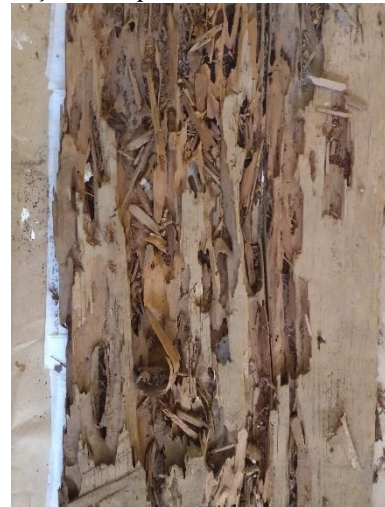
Figura 34 - Detalhe da fragilidade estrutural das tábuas com infestação de cupins ativos.
