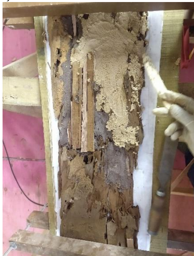
Figura 39 - Consolidação das tábuas do forro com enxertos de ripas e aplicação de massa de consolidação.
