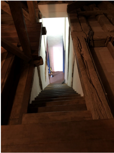
Figura 18: Escada parcialmente construída para complementar o acesso ao sótão. Fotografia do autor.
